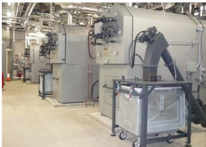
Quatre chaudières à bois Pyrotec KPT-1250 assurent le chauffage de locaux et d'ECS à distance
