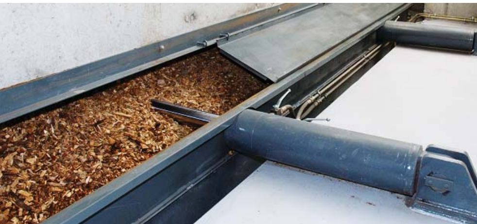
Installation à plancher praticable
